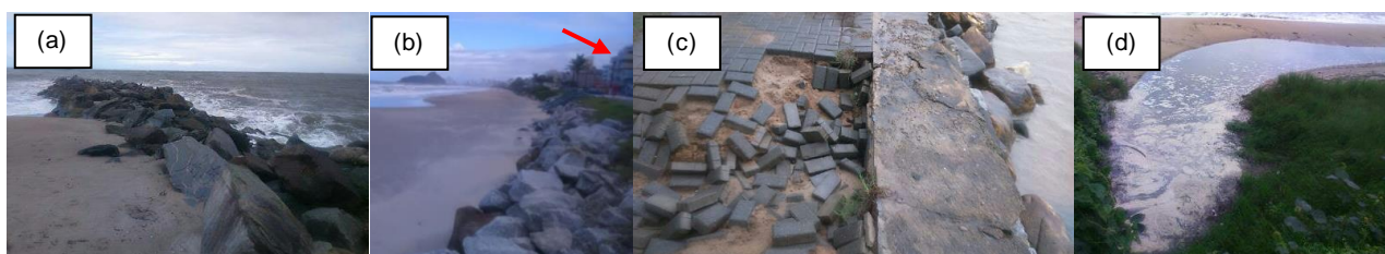
FIGURA 1 – Tentativa de contenção de erosão através de técnicas estruturais e agentes causadores
